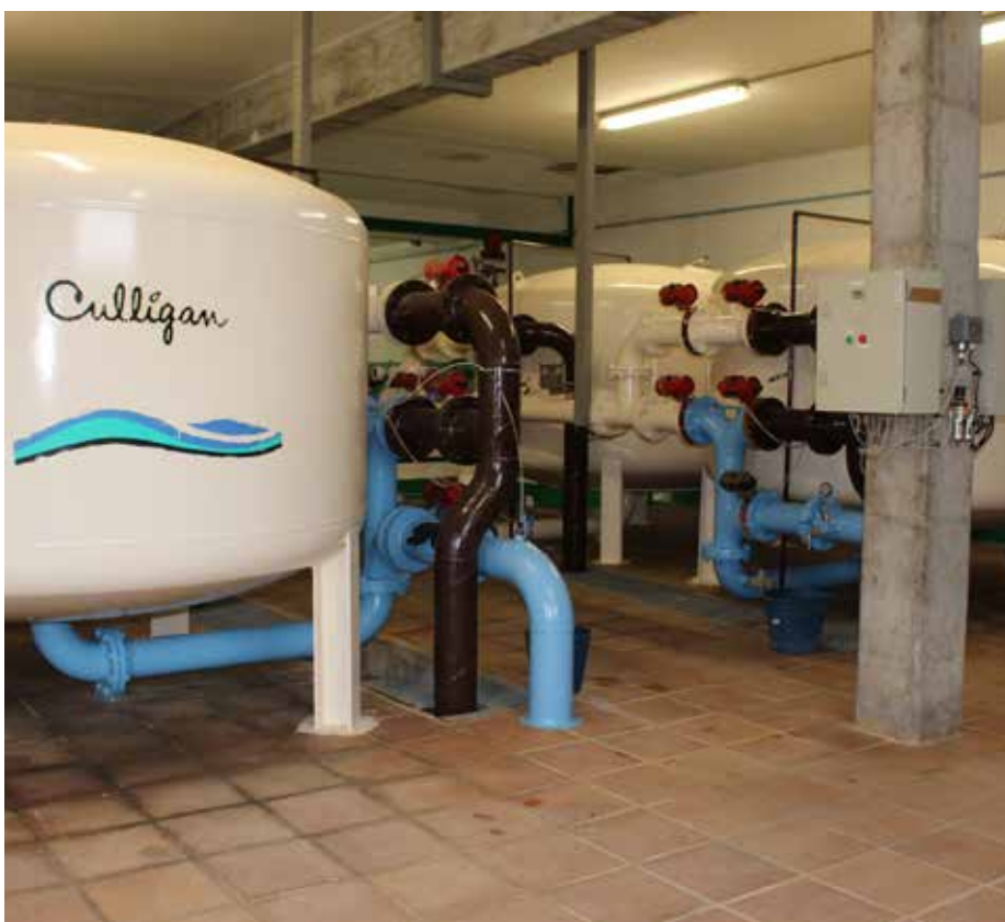
Planta de tratamiento para la potabilización del agua de boca de Binéfar.
